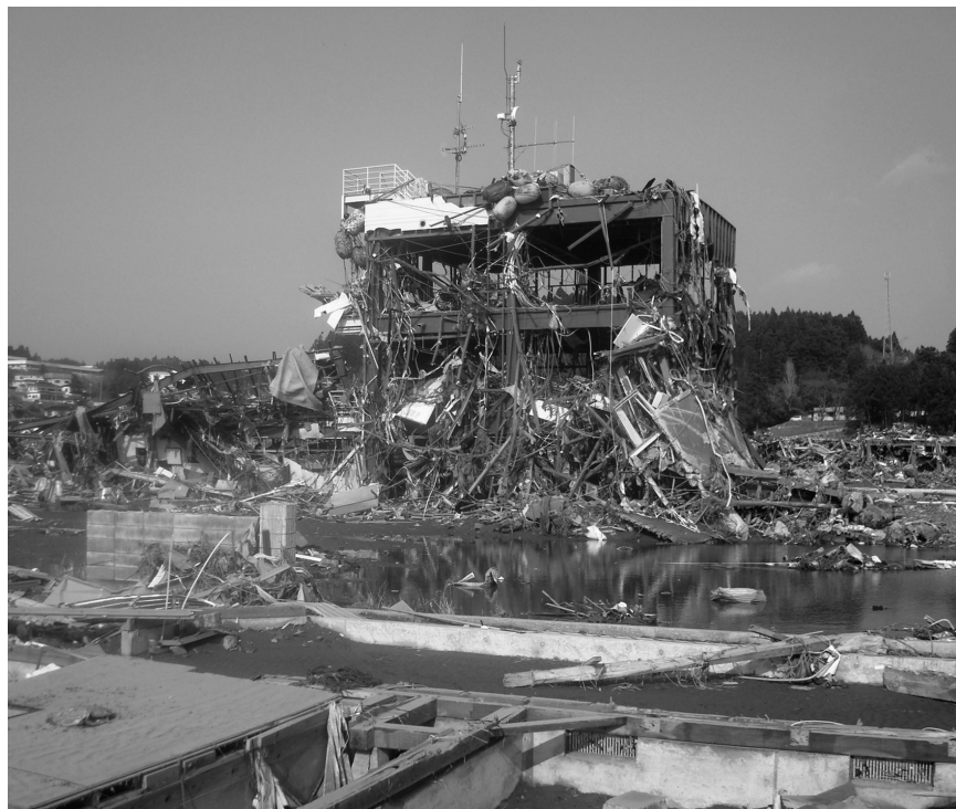
鉄骨だけとなった南三陸町の防災対策庁舎。津波のすさまじさかわかる(11年3月13日)
